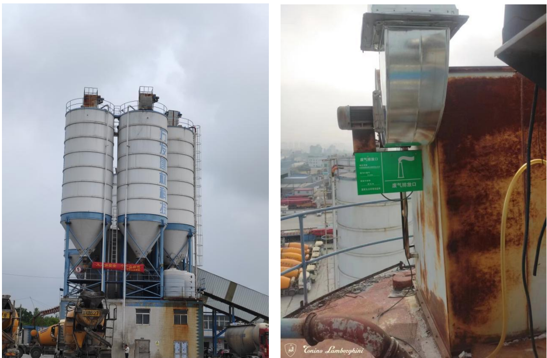
图 3-3 废气处理装置及排气筒标识标牌
